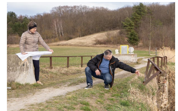
Stadträtin Andrea Hugl überzeugt sich gemeinsam mit Gemeinderat Wolfgang Inhauser vom baufälligen Zustand der alten Mistelbrücke.
